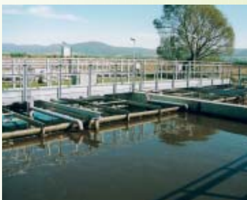
Novovybudovaná čistička odpadových vôd Neugebaute Abwasserkläranlage A newly built wastewater treatment plant
