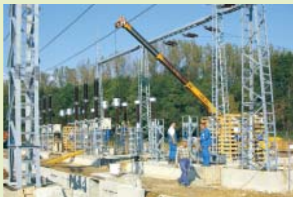
Nová elektrická stanica Neue Elektrostation New electric station
